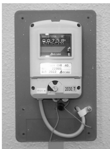
▶ 施行前：旧水道メーター
