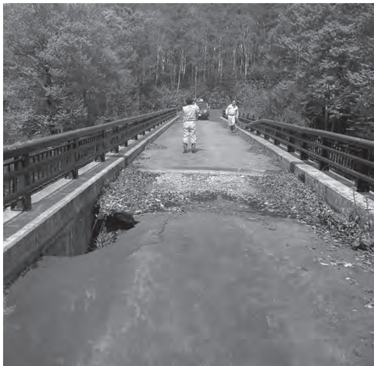
一部損壊した 賀老2号線 ふれあい橋
