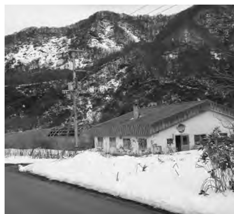
▲老朽化のさけ・ますふ化場（宮内地区）
