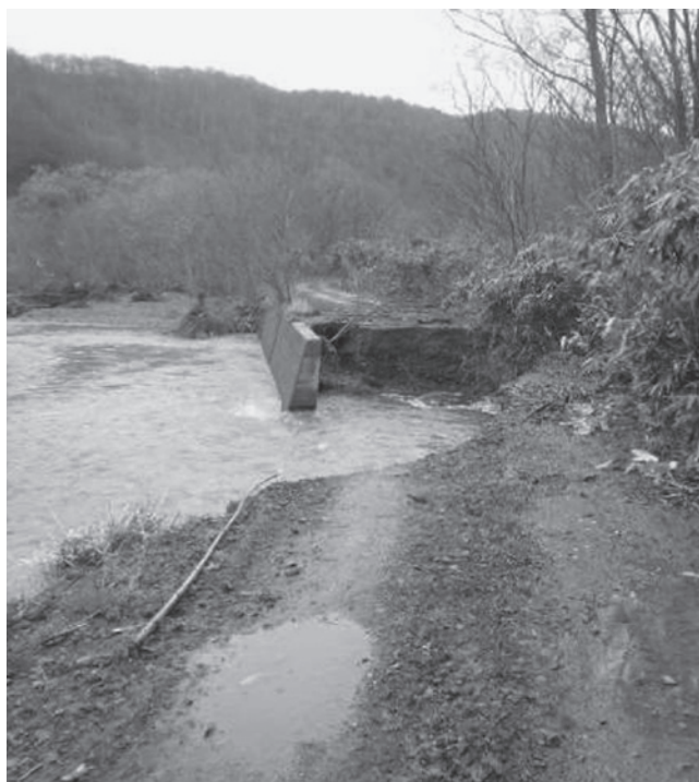
▲村道折川奥開墾通線の被災箇所
