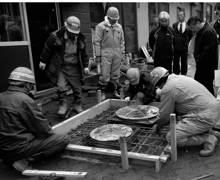
▲村が発注し施工されている個人住宅の合併処理浄化槽
