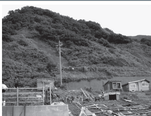
第二栄浜漁港、斜面崩落、巻上げ機小屋等が被災。
