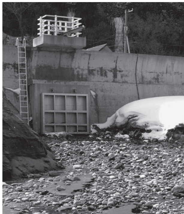
△ 江ノ島海岸に設置されているフラップゲート
