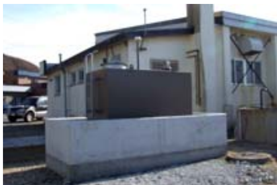
給食センターの重油タンク
